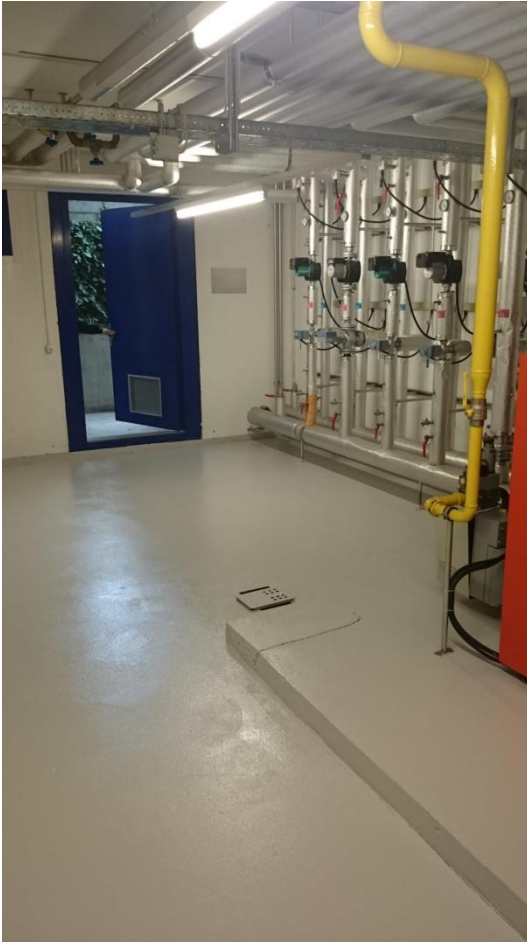
Chaufferie école vélodrome
