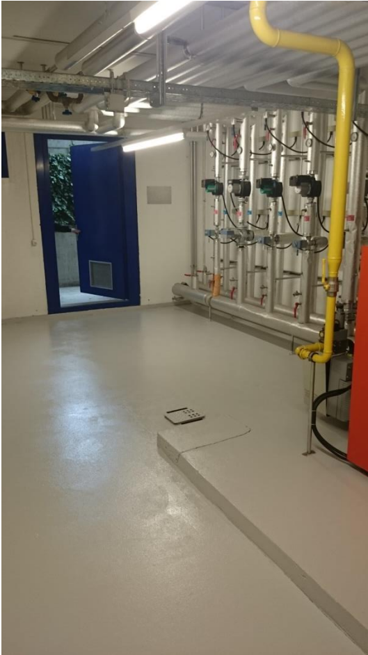
Chaufferie école vélodrome
