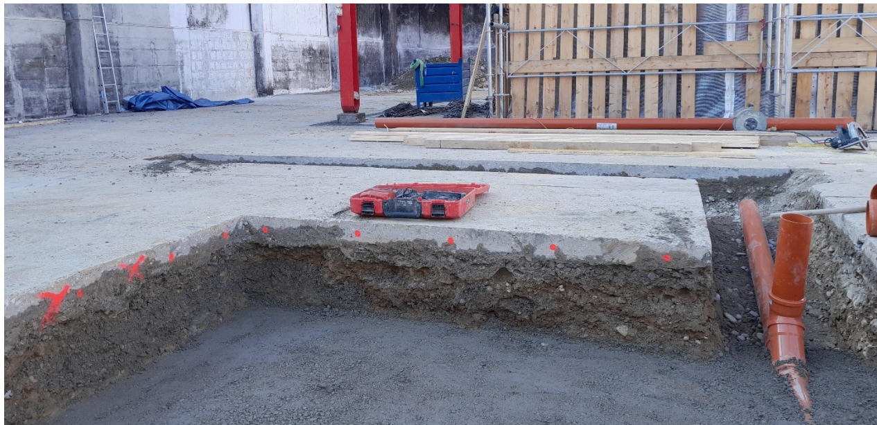
Photo montrant la faible épaisseur du radier existant et l'absence de ferrillage
