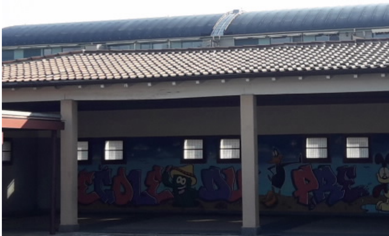
Photo de la déformation
