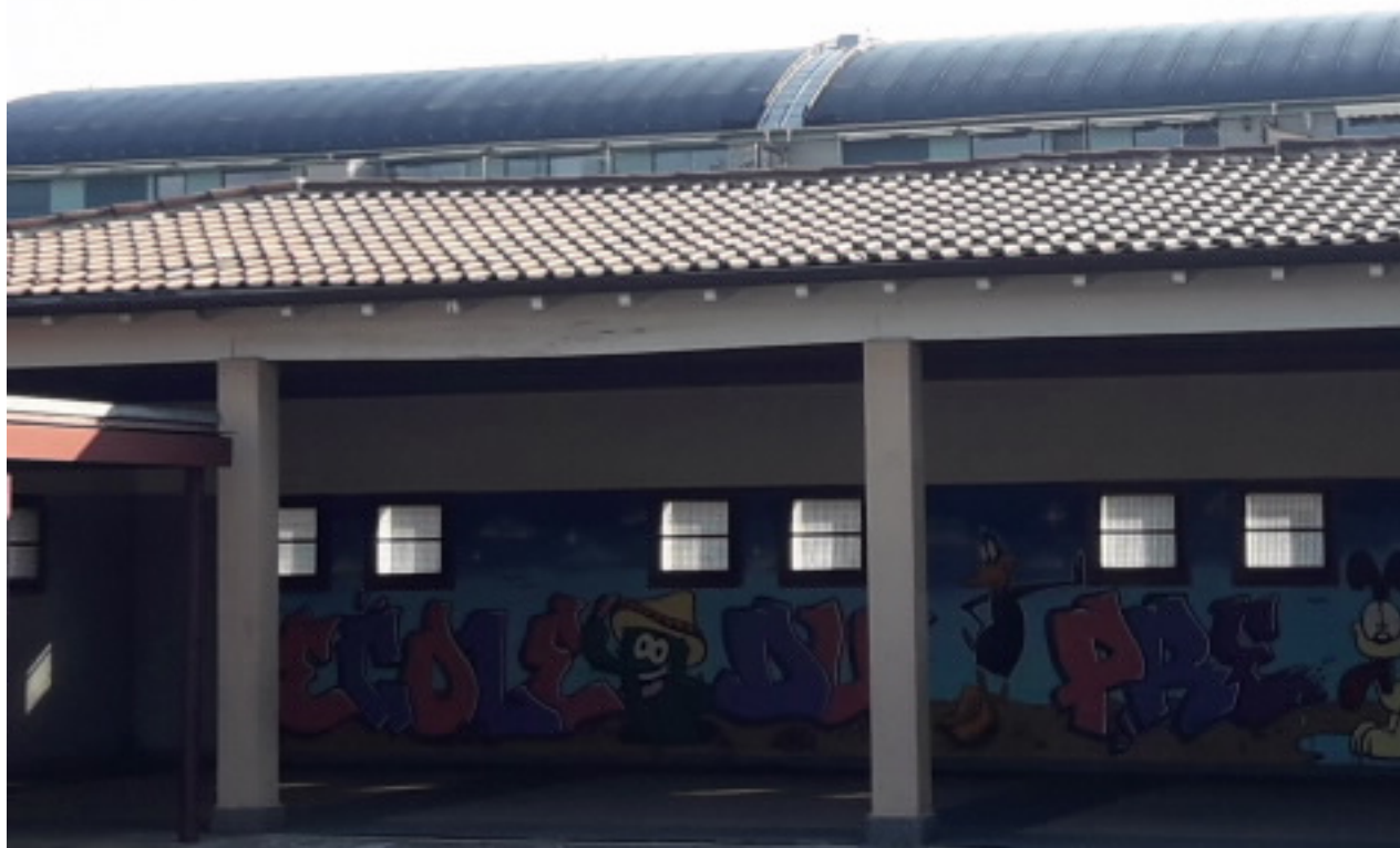
Photo de la déformation
